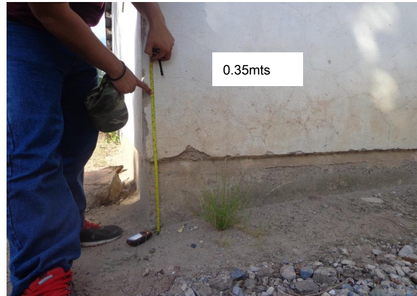
Imagen V.2.11.1.51 Vista desde el punto 10. En el interior de las instalaciones de la escuela secundaria en el poblado de Piaxtla de Abajo. En la cual se puede observar una medición del nivel de agua que se indicó por parte de la directiva de la escuela. En la cual se calculó un tirante de agua de 0.35 mts. Durante la inundación de 1993.
