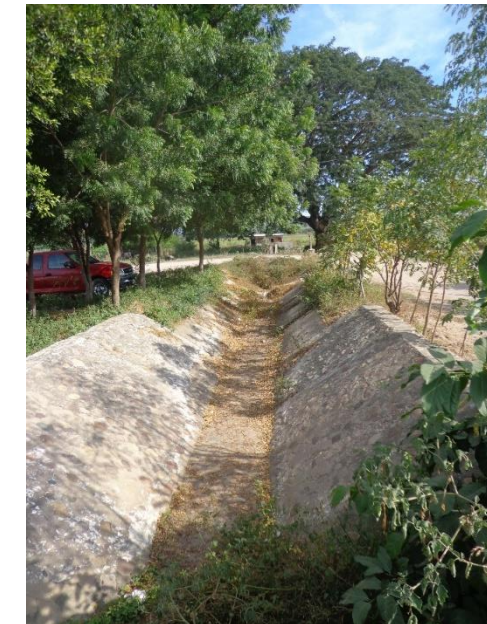
Imagen V.2.11.1.48 Vista desde el punto 8 hacia el Norte de la calle Santos Degollado, en el poblado de Piaxtla de Abajo. En la cual se puede observar el sistema de riego que corre paralelo a la calle Santos degollado.
