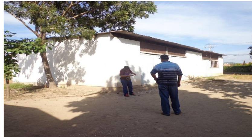
Imagen V.2.11.1.50 Vista desde el punto 10 en el interior de las instalaciones de la escuela secundaria en el poblado de Piaxtla de Abajo. En la cual se puede observar una de las instalaciones existentes.
